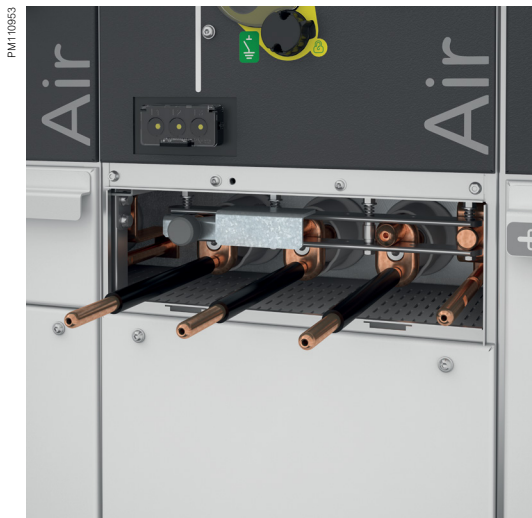
Abb. 3: iCTF-Zugangsabdeckung mit Injektionsfingern geöffnet.
